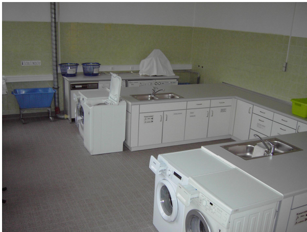
Waschküche mit Waschmaschinen und Trocknern
